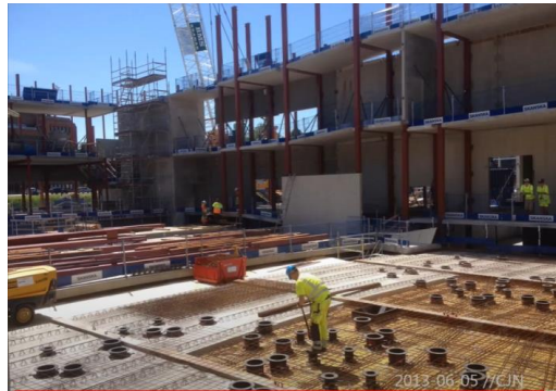
Şekil 24. Titreşim sönümleyici uygulaması (CALLEJRJR, 2017).
