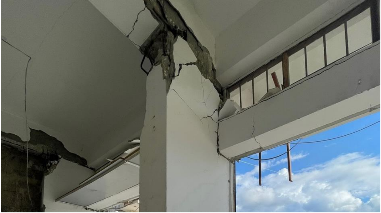
Resim 2. Kısa kolon etkisi (iki bant pencere arasında kalan kısa kolonda deprem sonrası oluşan zarar)
