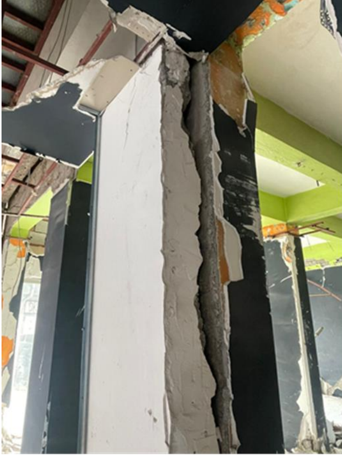
Resim 6. Kırıkhan'da bitişik iki yapı arasındaki yetersiz dilatasyon boşluğu
