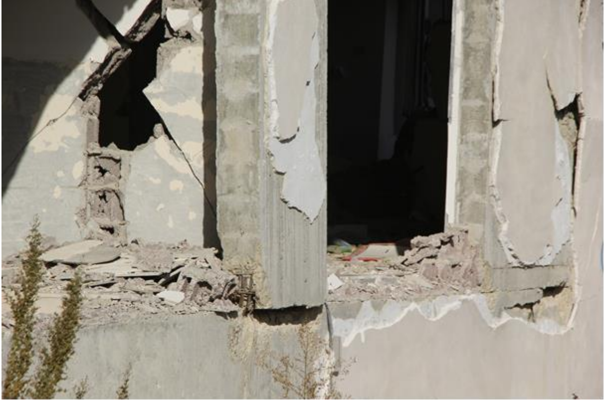
Resim 9. Samandağ'da tespit edilen taban alanı yapı alanı dışına kaydırılmış kolon
