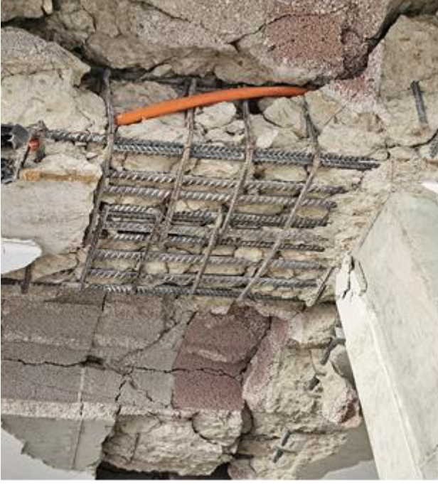
Resim 7. Kirişe yerleşmiş kablo ve buat ile kesit alanı zayıflatılmış zarar görmüş betonarme kiriş
