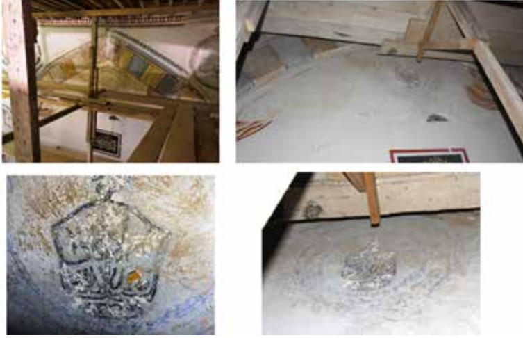
Grsel 62: Harim Kuzey duvarı, sivri kemer alınlıđında mekanik raspa ile aıđa ıkarılan yazı ile perde desenine ait izler (Yazar, 2023).
