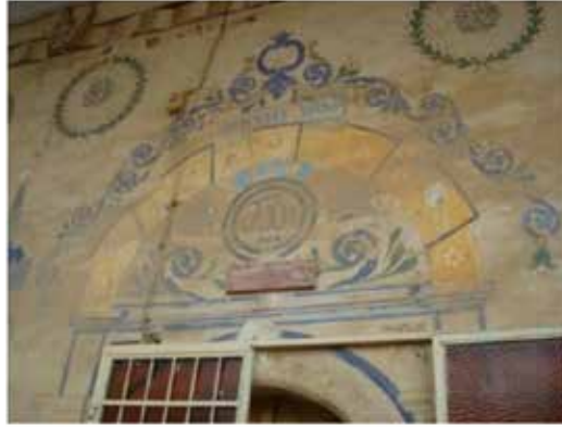
Görsel 44: Afyon Dazkırı, Kızılören Köyü Camii, harim giriş açıklığının üst kısmındaki bitkisel süslemeler (D. Şener, 2011, 544)
