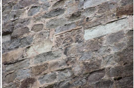
Res. 19: Kanuni Suru-Devşirme Malzeme
