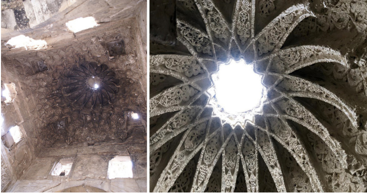
Fot. 9: a. Süleyman Han Külliyesi kapalı avlu alçı süslemeli kubbe özgün hali, b. Latex uygulaması sonrası (KVMGM arşivi)
