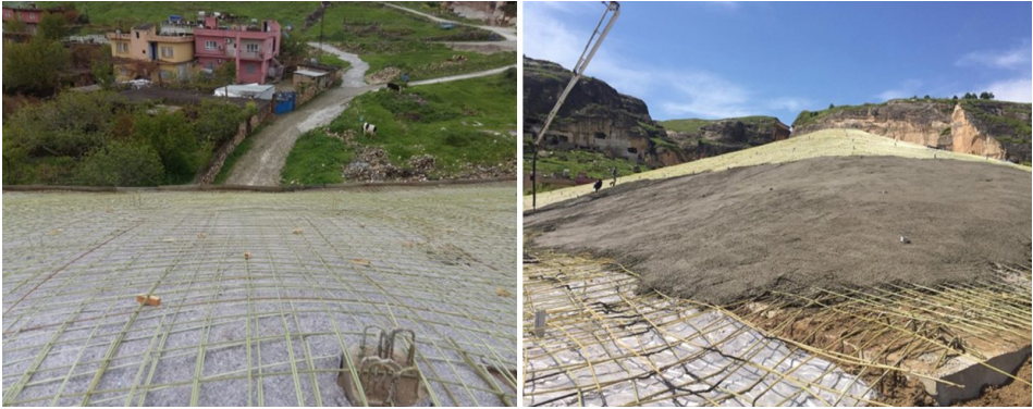
Fot. 14: Süleyman Han Külliyesi ve Koç Cami betonarme koruma kabuğunun cam elyaf donatıları
