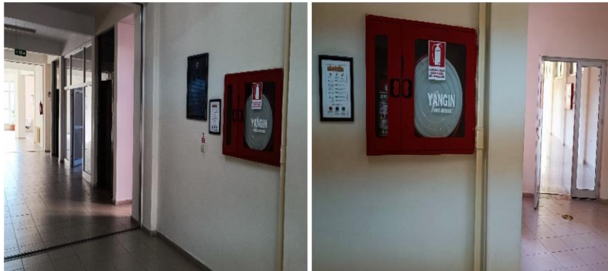
Şekil 10. MDBF binası yangın dolapları Figure 10. Fire cabinets in the MDBF building
