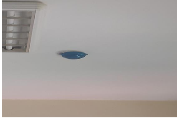
Şekil 12. MDBF binasının yağmurlama sistemi Figure 12. Sprinkler system of the MDBF building
