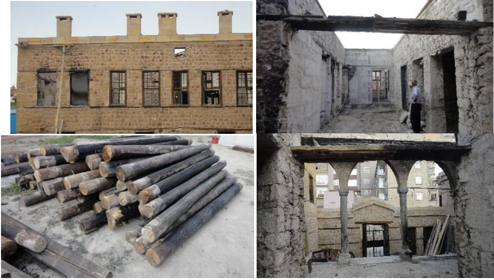
Şekil 7. Göncü Konağı Yangın Sonrası (Efe Yavaşcan, 2012)
