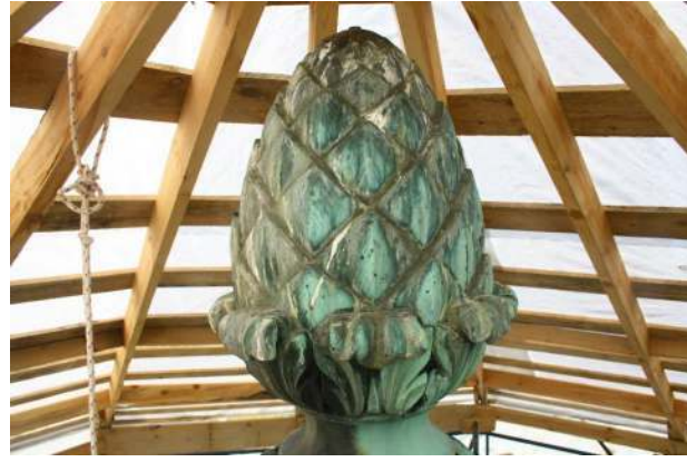
Fig. 10 Alman eşmesi'ndeki metal kubbenin konservasyon uygulamaları öncesi hali (S.Tulgar).
