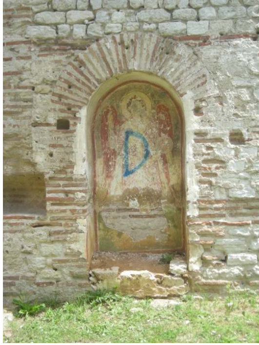
Fig. 9 Yapının dođu dıř duvarında yer alan niř ierisinde yer alan duvar resmine, insan eliyle verilen zarar. Hande Gnz.
