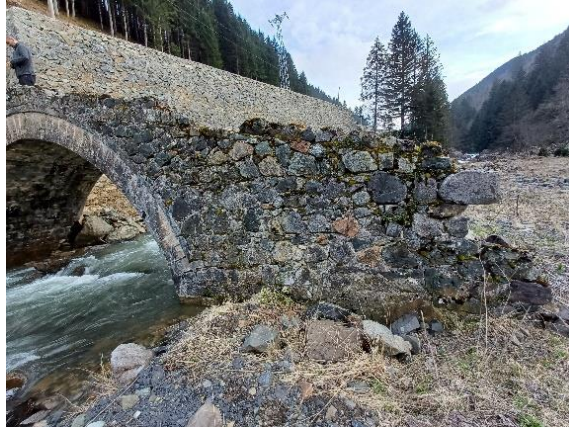
Foto. 51. Binatlı (Terzili, Cingalli) Köprüsü Yıkık Bölümleri (2024)
