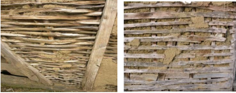
Görsel 13. Halk Arasında Anılan “Çiteme” Tekniğiyle Oluşturulmuş Duvar Dolgu Örneği. Bağdadî Çıta Tekniği İle Oluşturulmuş Bağdadî Duvar (Bayraktar, 2020).
