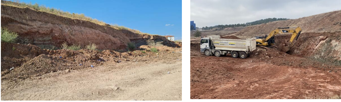
Fotoğraf 3. Çankırı Yapraklı Yolu TOKİ İnşaat Alanı (Sol), TOKİ İnşaat Hafriyatı (Sağ) (Kuzeye doğru, 20.08.2024) (Kaynak: Nazan Karakaş Özür-2024)
