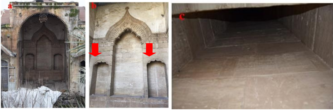
Şekil 28: a. Eyvanın genel görünüşü, b. Eyvan içinde hava kanalının yeri, c. Hava kanalının içten görünümü
