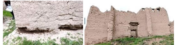
Şekil 4. 3 numaralı güvercin evinde(boranhane) meydana gelen nem hasarları
