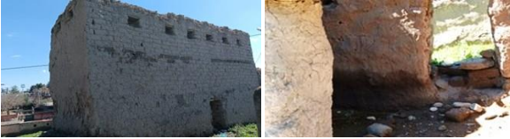
Şekil 6. 5 numaralı güvercin evinde (boranhane) meydana gelen nem hasarları
