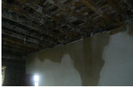
Fotoğraf 3. Aşhane kısmında görölen tahribat
