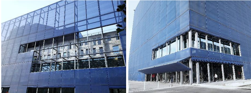
Şekil 7. Dış cephe fiberglas kaplamanın güneş kırıcı olarak kullanılması (M. Kavraz Arşivi, 2017).
