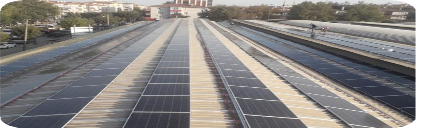
Resim 7: Karizma Kapalı Pazar Yeri Güneş Enerji Santrali
