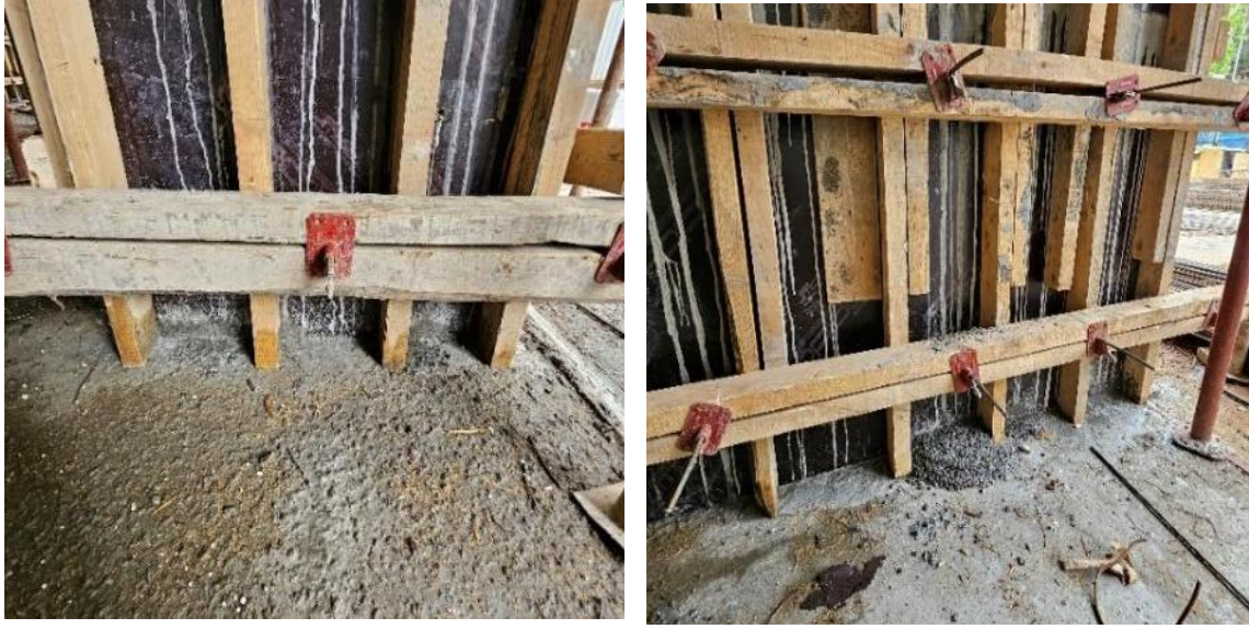
Şekil 5: Kalıptan beton sızma görseli (Yazar tarafından üretilmiştir, 2024)
