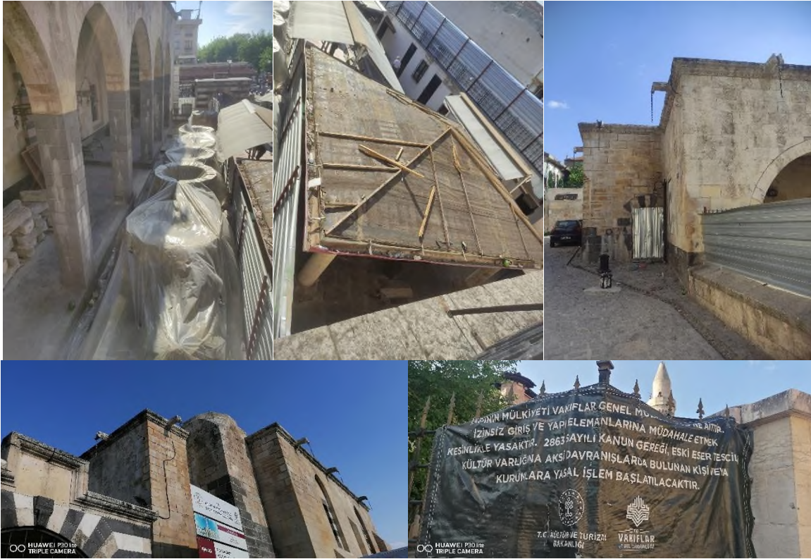
Şekil 2. 6 Şubat 2023 Kahramanmaraş Depremi Sonrası Tahtani Cami Durumu
