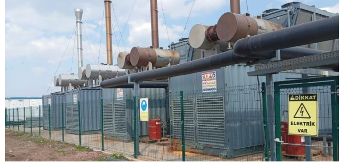
Şekil 10 Elektrik üretim tesisi
