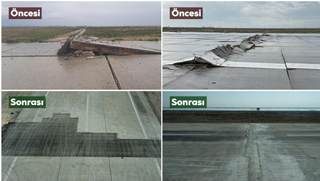
Görsel 8: Hatay Havalimanı Deprem Hasar (DHMİ, 2023)
