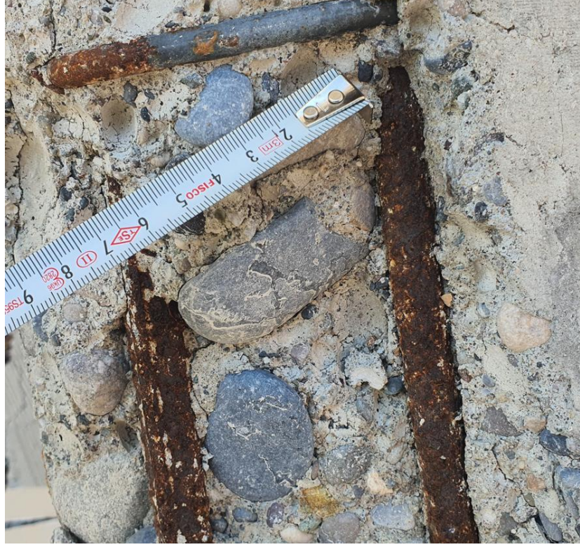
Şekil 8. Betonda uygun olmayan gradasyon
