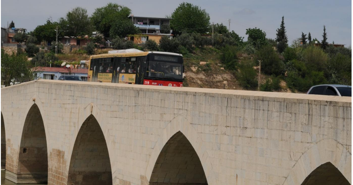
Şekil 18. Batı Cephesi 6.,7.,8. Gözlerin Kemerlerinde Açılma ve Çatlaklar (2023)
