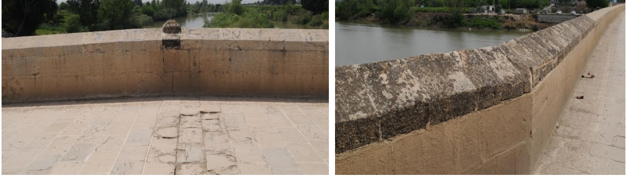
Şekil 19. 5. Göz Korkuluk Duvarında Açılma ve Çatlaklar (2023)
