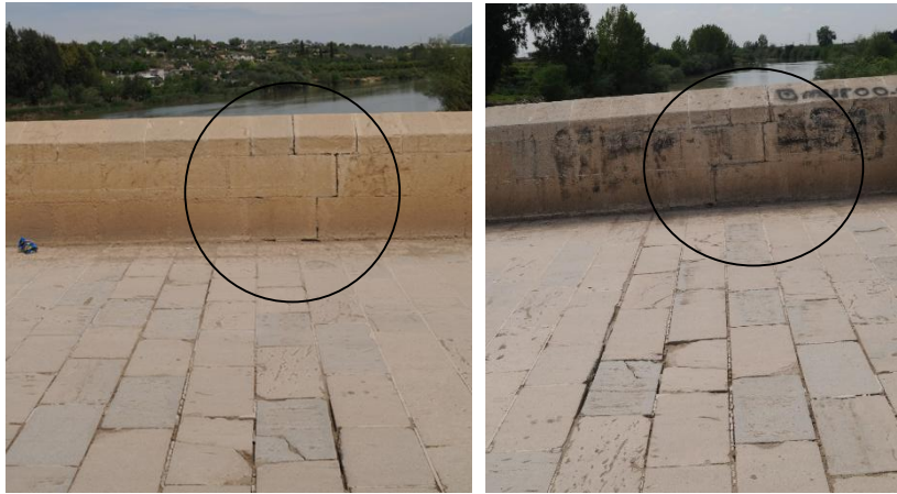
Şekil 16. Korkuluk Duvarlarında ve Yol Kaplamasında Açılmalar 2023 (yazar arşivi)
