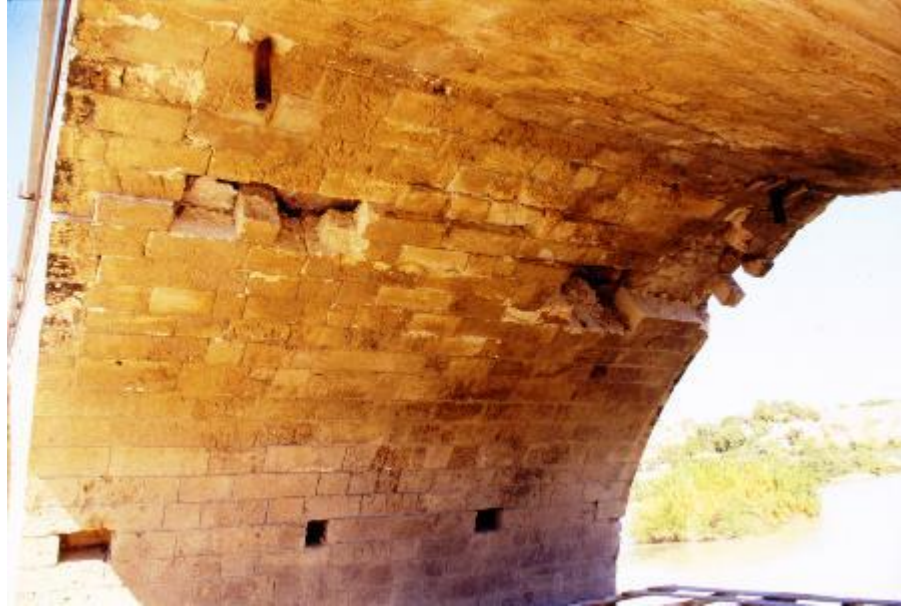
Şekil 6. 7.Açıklık ve Kemerde Hasar (Yeğın, 1998)
