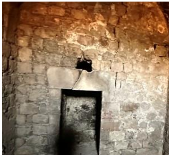
Şekil 25. IIIM14 mekanında yer alan lentoda görülen çatlak hasarı, © 2024 Çuha.
