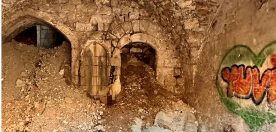
Şekil 22. IIIM13 mekanı pencere kemerinde görülen ayrışma hasarı, © 2024 Çuha.
