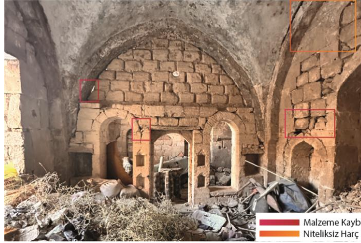
Şekil 20. IIIIM12 mekanında görülen derz boşalmaları ve niteliksiz harçlar, © 2024 Çuha.
