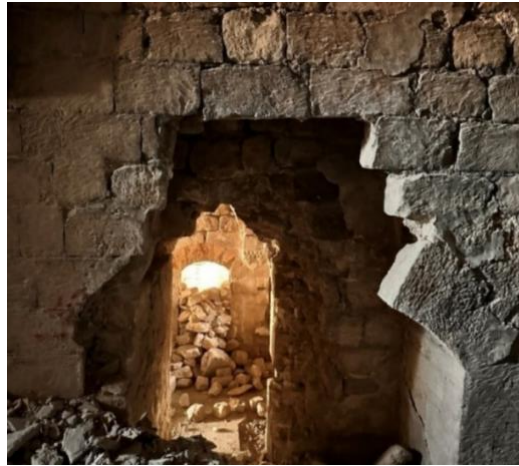
Şekil 24. IIIM14 mekanında IIIM2 mekanına girişi sağlayan kapı kemerindeki hasarlar, © 2024 Çuha.
