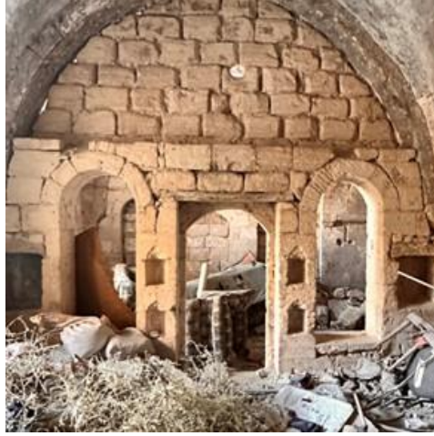
Şekil 26. IIIM12 mekanında lento ve kemerlerde görülen hasarlar, © 2024 Çuha.
