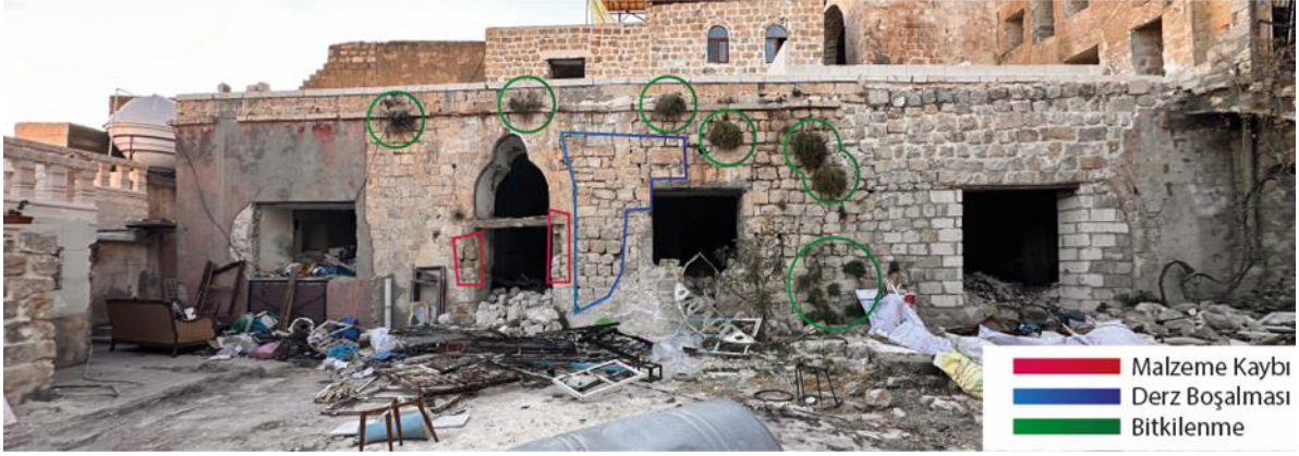
Şekil 16. 3 numaralı yapı bloğu doğu cephesindeki malzeme kaybı ve bitkilenme, © 2024 Çuha.
