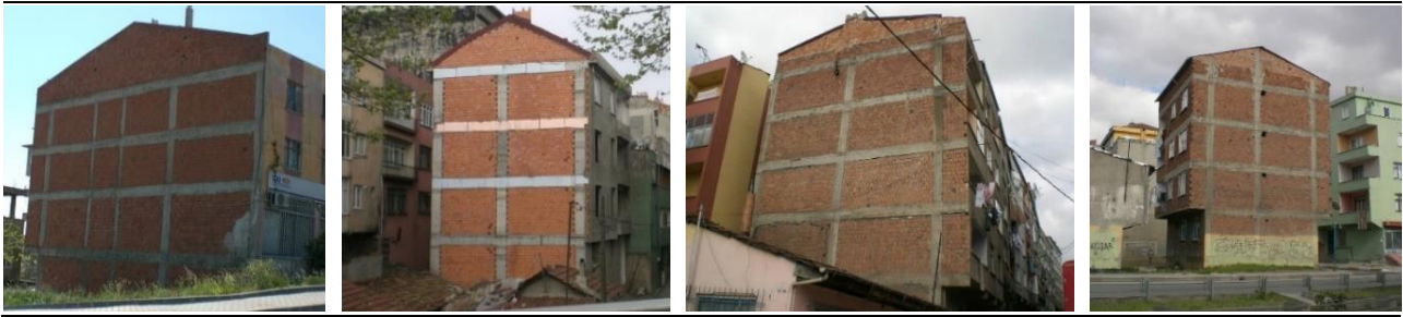
Şekil 2: İstanbul’da yer alan kronik problemlili betonarme bina örnekleri.
