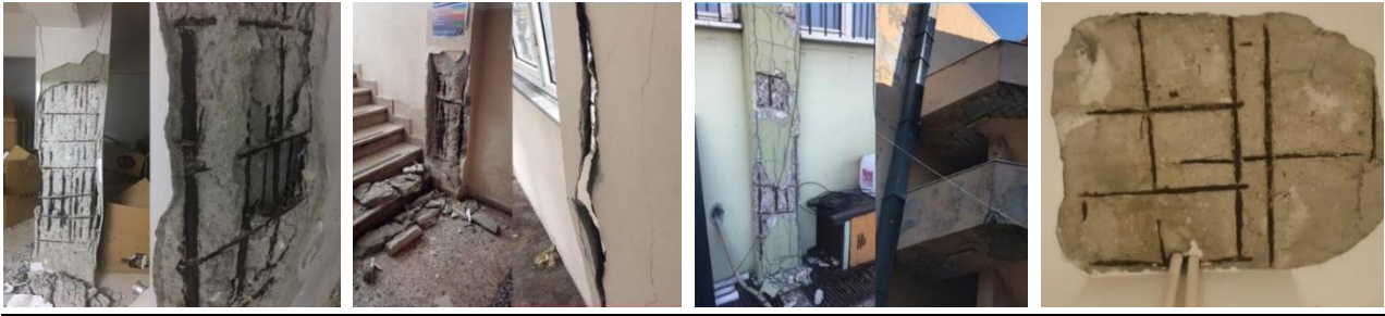
Şekil 1: Deprem sonrası betonarme yapılarda gözlenen yapısal hasarlar.
