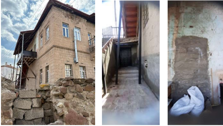
Şekil 10. Hacı Osman Ünsal Evi'nin doğu cephesine yapılan muhdes merdiven ve III. Dönemde doldurulan kapı (Ata Ünsal, 2025; Ata Ünsal vd., 2023: 94)
