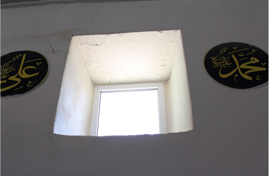
Fotoğraf 31: Hisarköy Camisi Mahfil Katı Batı Duvarı Yeri Alan Pencere Kenarındaki Deforme Olmuş Alçı Silme
