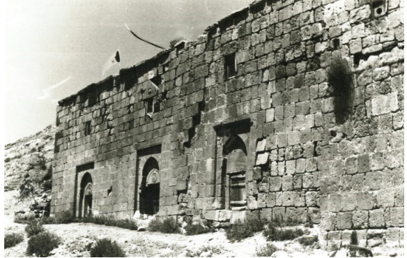
Fot. 10a: Güney cephe duvarında özellikle de üst kotlarda izlenen yapısal ve malzeme bozulmaları
