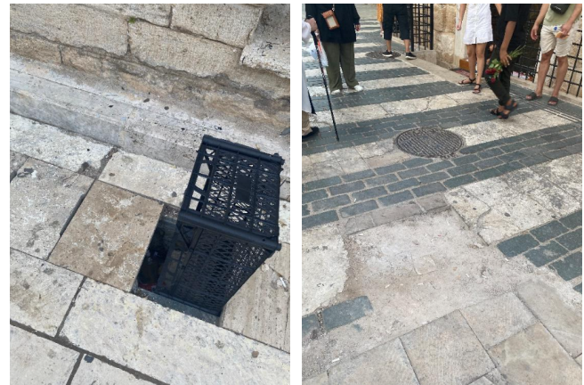
Şekil 10: Kılınçarslan Mahallesi, Kötü Durumdaki Yol Görünümleri
