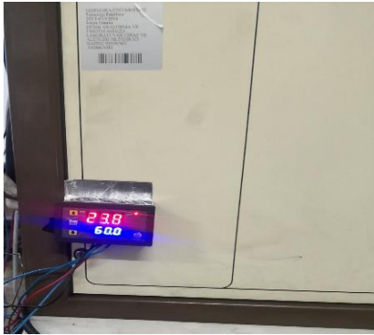
Şekil 12. Sıcaklık kontrol paneli
