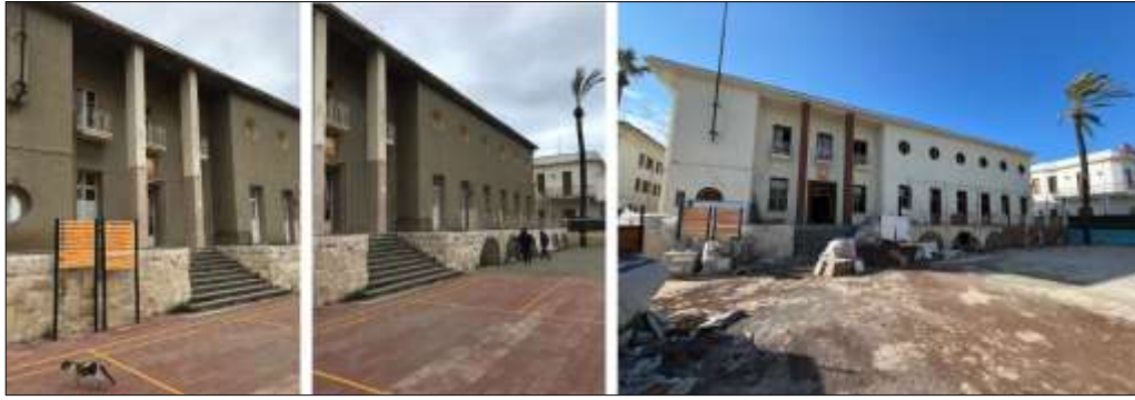
Şekil 12. Kuzey cephesi, 2022, 2024 (Yazarlar)
