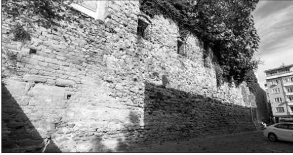
Foto-13: Caminin güneyindeki istinat duvarı ve üzerinde medreseye ait duvar kalıntısı.
