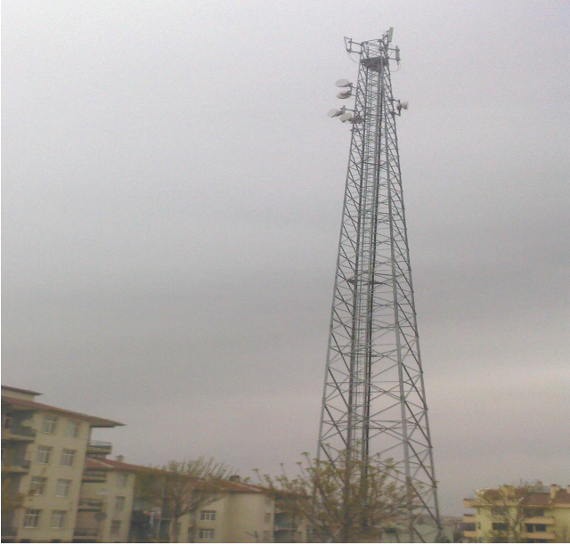
Şekil 2.1 Baz İstasyonu Kulesi
