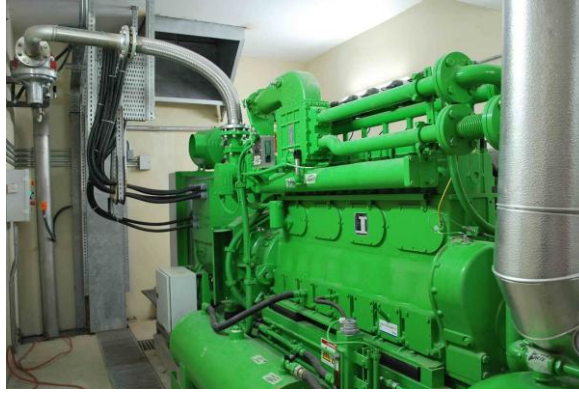
Resim 9. Muğla arıtma tesisi biyogaz kojenerasyon santrali
