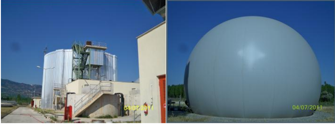
Resim 1: Çamur homojenizasyon tankı ve anaerobik çamur çürütme tankı Resim 2: Biyogaz depolama tankı
