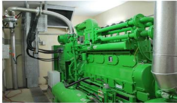
Resim 3: Tokat atık su arıtma tesisi kojenerasyon tesisi
