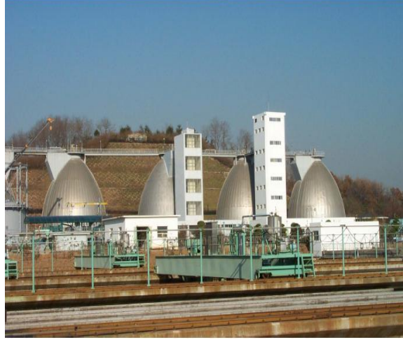
Resim.8. Kocaeli büyükşehir belediyesine bağlı İSU'ya ait 42 evler atıksu arıtma tesisi
