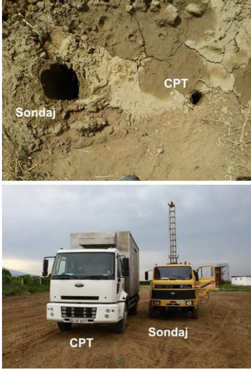
Şekil 2. Yapılan sondaj ve CPT uygulama noktalarının yakınlığı örneklerinin temsil ediciliğinin artırılmasını sağlamıştır
