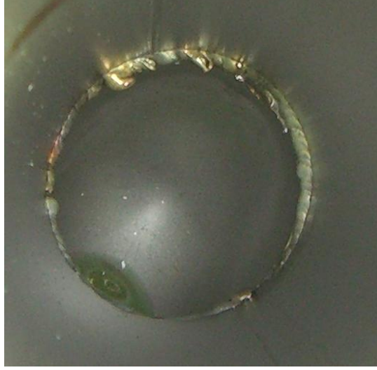
Foto 7. Uygun olmayan paslanmaz boru kaynağı
