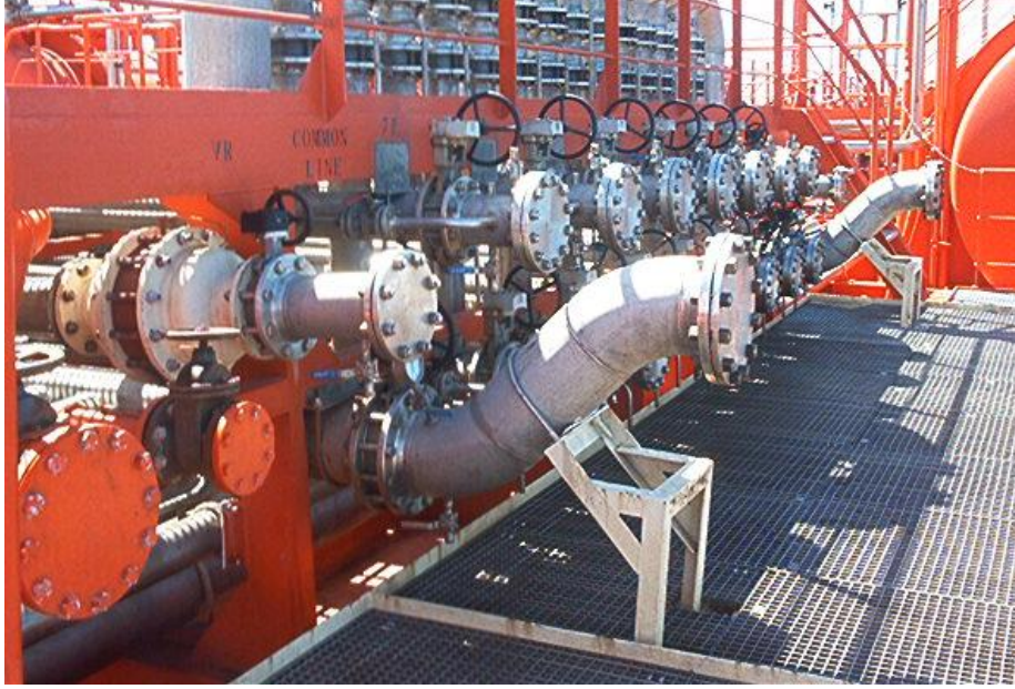
Foto 3. Kargo manifoldu doldurma boşaltma istasyonu. Manifold tavaşından CL ye bakış.
