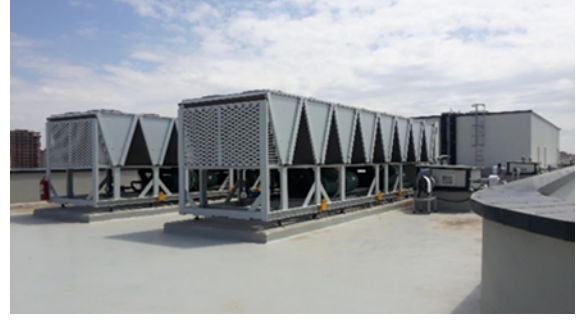
Resim 14. Konya Gıda ve Tarım Üniversitesi Yapay Havalandırma Sistemleri
