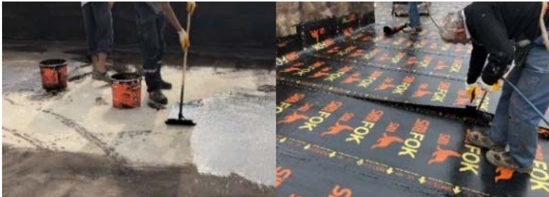
Şekil 2. Bitümlü astar uygulaması (solda), PB-SYÖ ek yerlerinin şalümo alevi ile yapıştırılması (sağda) [18] (Bitumen primer application (left), Bonding the joints of PB waterproofing membrane with torch flame (right)) [18]
