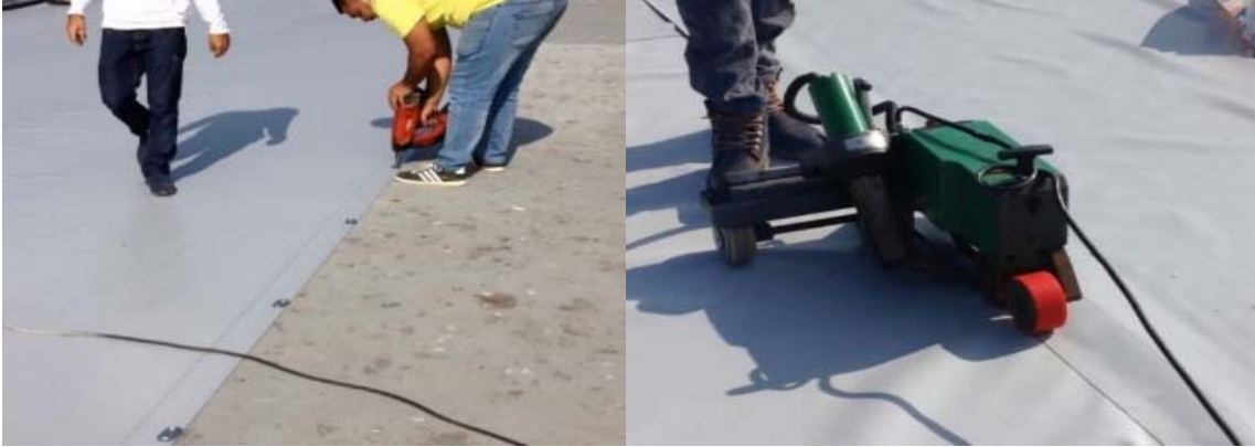
Şekil 3. PVC-SYÖ’lerinin beton döşemeye mekanik olarak sabitlenmesi (solda), Bini yerlerinin robot kaynak makinesi ile yapıştırılması (sağda) [18]
