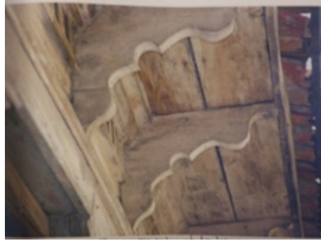
Fotoğraf 29: Mehlika Özcan Evi. Çatı saçağı payandası
