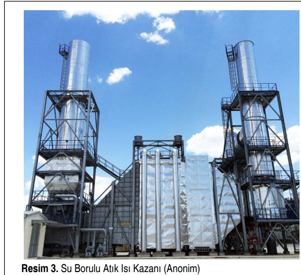
Resim 3. Su Borulu Atık Isı Kazanı (Anonim)
