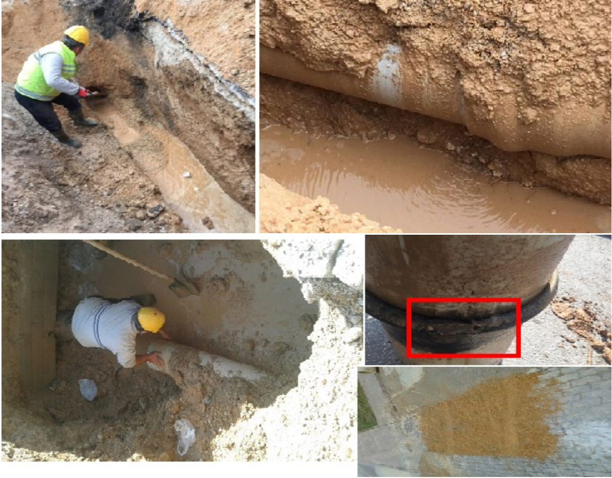
Şekil 8. Çalışma alanında tespit edilen arızalar
