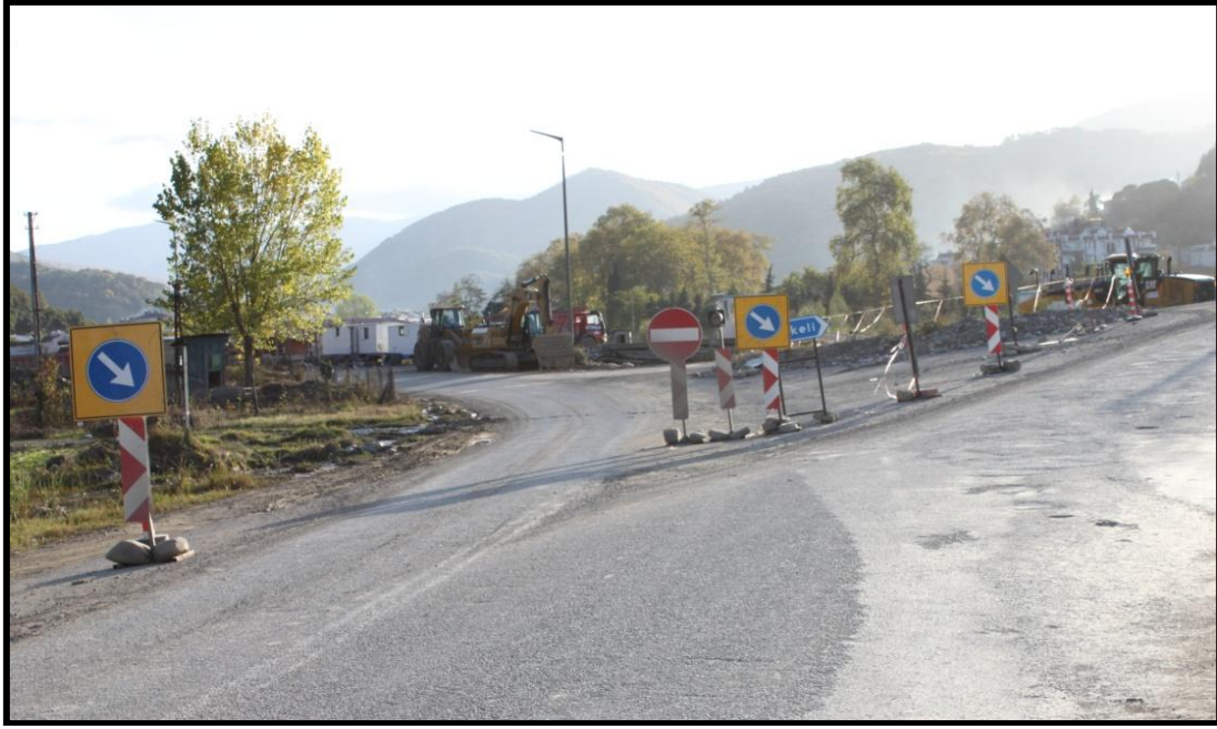
Şekil 11. HES santral binası ve kuyruk suyu boşaltım tesisi inşaatı nedeniyle kullanıma kapatılan çevre yolu (Figure 11. The highway closed to traffic because of the construction of HEPP and the tail water plant)
