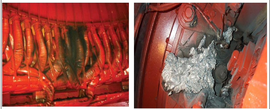
Şekil 4. Rüzgar Türbinlerinin Rotor Sargılarında Meydana Gelen Arızalar [18]
