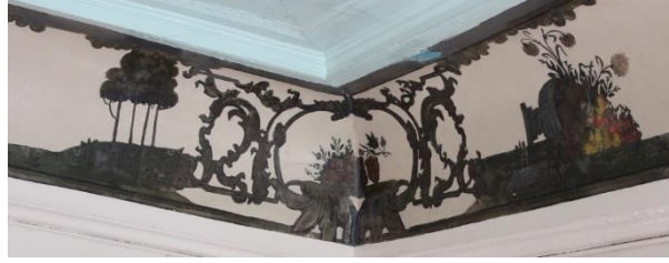
Resim-20: Hacı Mehmed Ağa Camii Harim Güneydoğu Köşesi Süsleme Detayı.
