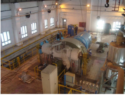
Şekil 7. Bakımı yapılan buhar türbininin genel görünümü.
