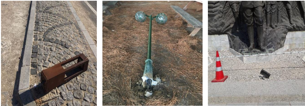
Şekil 4. Aydınlatma elemanlarında vandalizm
