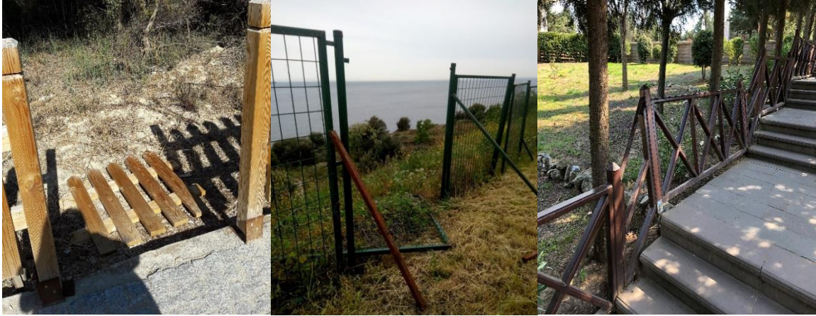
Şekil 3. Sınırlayıcı elemanlarda vandalizm
