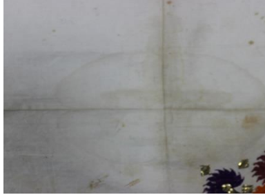
Şekil 15. Su Lekesi (Sağ orta)
