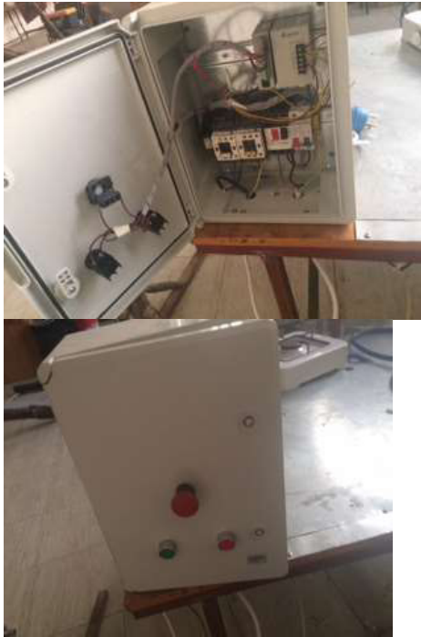
Şekil 4. PLC kontrol panosu (iç ve dış görüntü)
