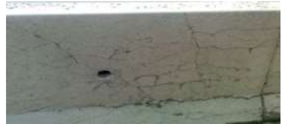
Şekil1. Avusturalya'da Köprü ayağında ASR etkisi sonucu gelişen çatlaklar (Wen.1998), Karayolu Koruma Bariyeri (Yıldırım.2011)
