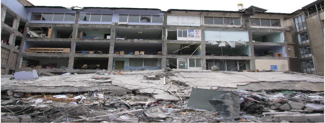
Şekil 26: Depremden Yıkılan İş Yeri Görünüşü (Ş. Öztürk)
