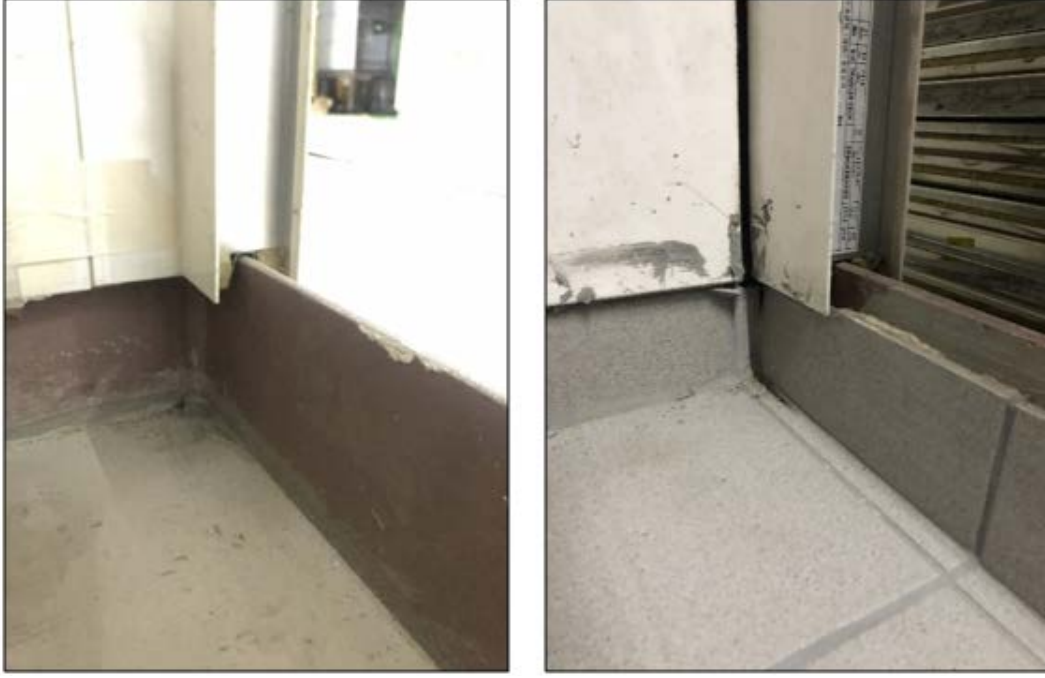
Şekil 8: Solda zemin kaplama ve süpürgelik uygulanmadan önce dere laması ve duvar paneli ilişkisi, sağda zemin kaplama ve süpürgelik uygulama işlemlerinden sonra dere laması ve duvar paneli ilişkisi (Fotoğraflar: Yazar).
