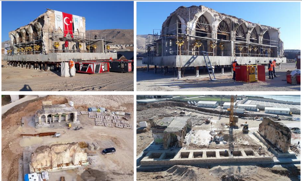
Resim 13. Hasankeyf Er Rızk Camiinin Arkeoark Alanındaki Yeni Konumunda Yeniden Kurulum, Montaj, Restorasyon ve Sergileme Çalışmaları (ER-BU İnşaat Tic. Aş. arşivi).
