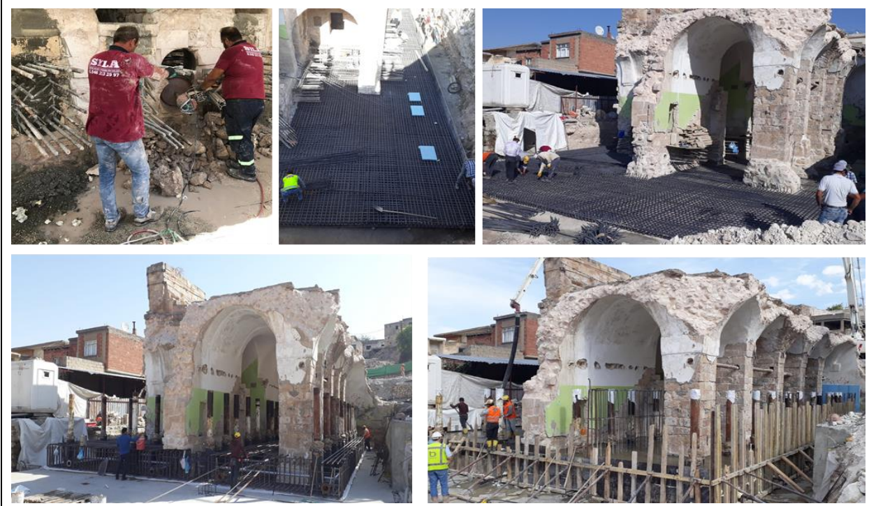
Resim 9. Hasankeyf Er Rızk Camii Revaklı Mekân Kütlesi Strüktürel Bütüncül Taşıma Projesi Betonarme Temel Zemini Platformu ve Betonarme Kaldırma Platformu İmalat Çalışmaları.
