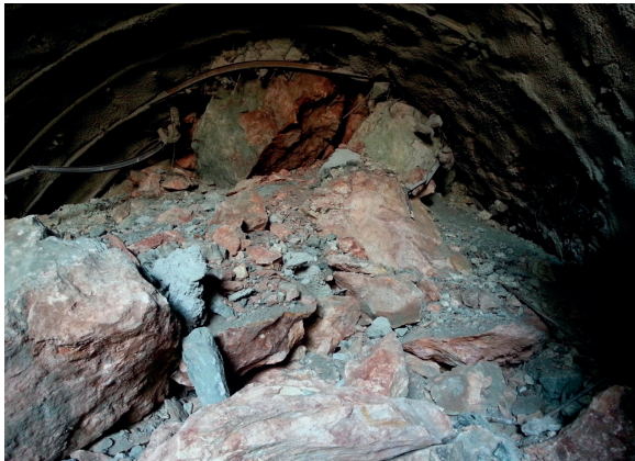
Şekil 3. Tünel içinde meydana gelen yenilmenin görünümü
