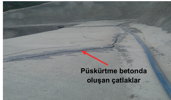
Şekil 4. T3 çıkış portalinde püskürtme betonda meydana gelen çatlaklara bazı örnekler
