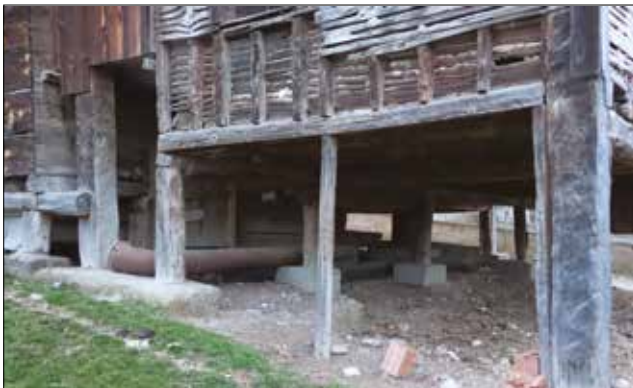
Fotoğraf 60. Taş kaidelerin betonarme kaideler ile değişimi, Çarşak Köyü / Stone bases replaced with reinforced concrete bases, Çarşak Village, 2015.
