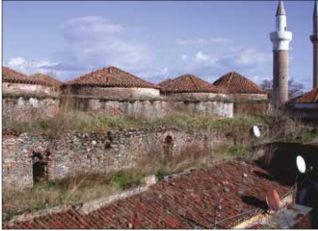
Fotoğraf 1 - Restorasyon öncesi çatının genel görünüşü / General view of the roof before restoration.
