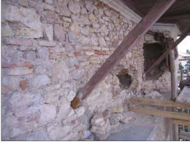
Fotoğraf 13 - Taçkapının arkasında, minare kapıları seviyesinde duvarda açılan bölüm (2007) / The distructed portion at the level of the minaret doors, behind the portal (2007)
