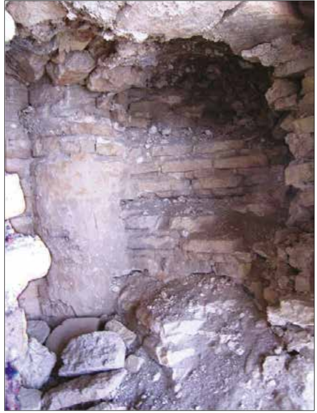
Fotoğraf 15 - Doğu yönde yer alan yıkılmış minarenin merdiven çekirdeği ve tuğla örgülü basamaklar (2007) / The brick steps and the core of the staircase of the collapsed minaret at the East (2007)
